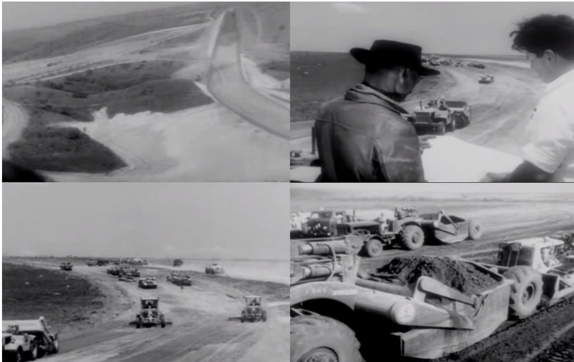
Da esquerda para a direita: vista aérea da construção de uma estrada próximo à Brasília; técnicos fazem a supervisão das obras e máquinas trabalham na planificação do terreno. Fonte: youtube.com
