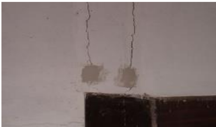
Figura 27 - Rachadura na parede do artesanato ao lado do Cine Teatro São Joaquim
