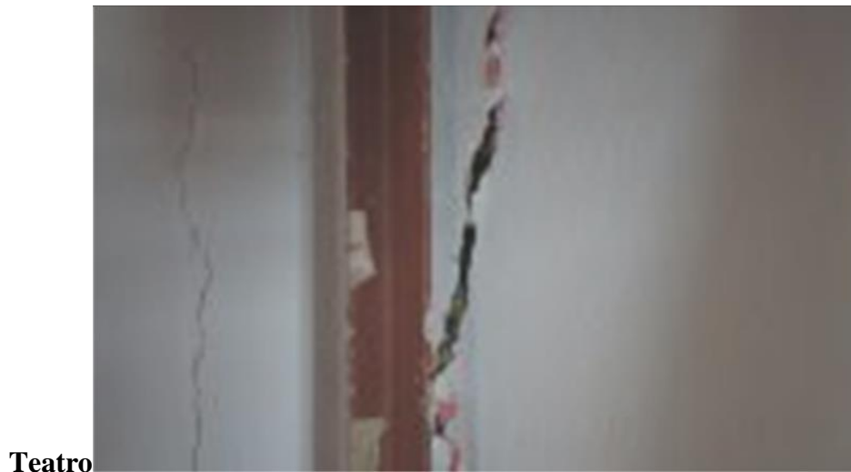
Figura 29 - Rachaduras na parede do
