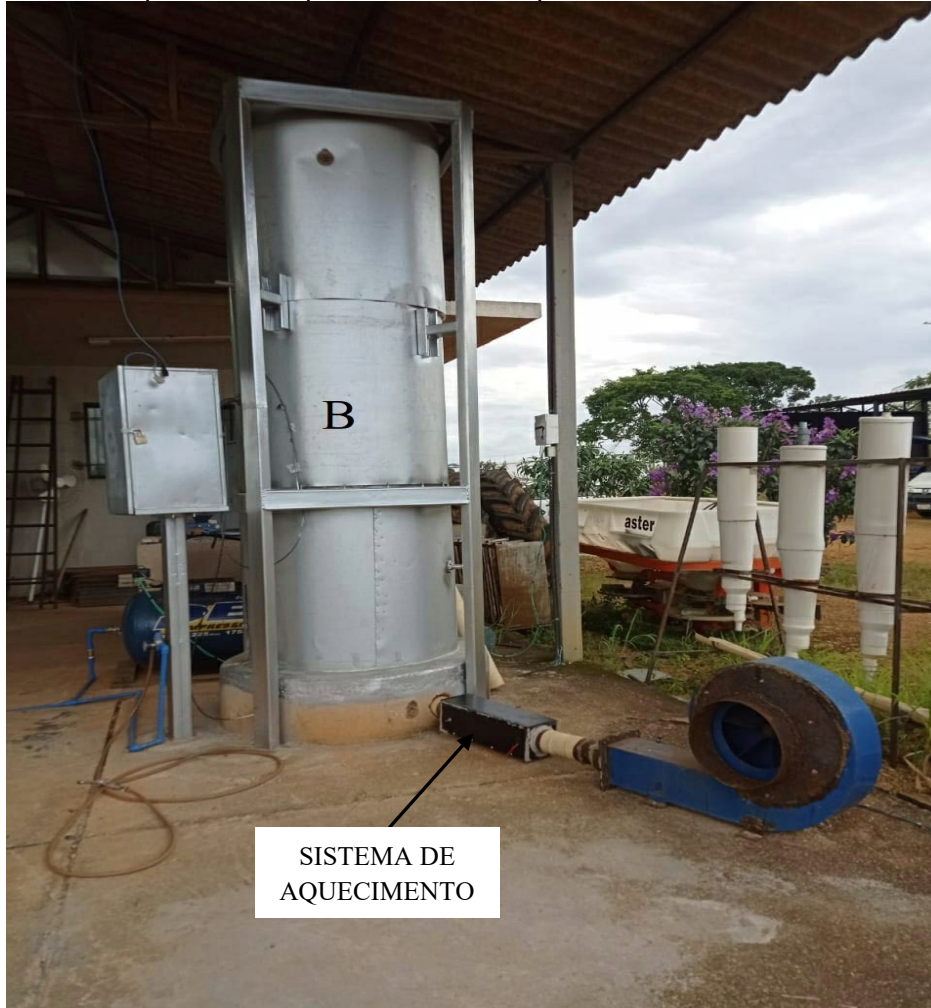
Figura 13 - Sistema de aquecimento acoplado ao ventilador e plenum
