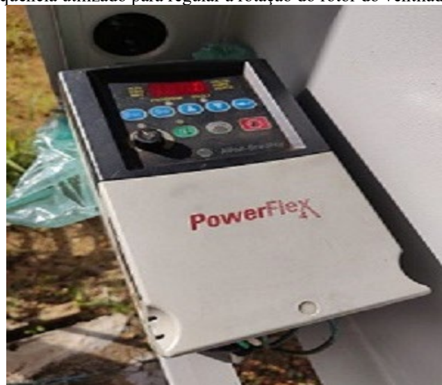
Figura 8 - Inversor de frequência utilizado para regular a rotação do rotor do ventilador
