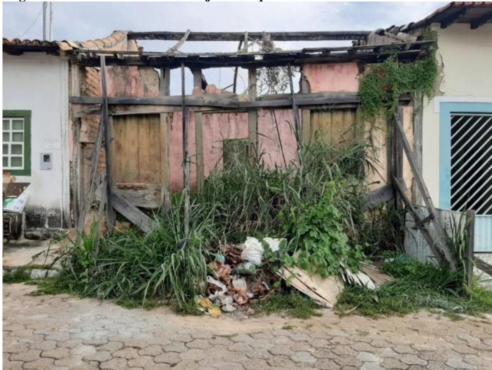
Figura 11: Casa em Ruínas no Conjunto Arquitetônico Tombado da Cidade de Goiás
