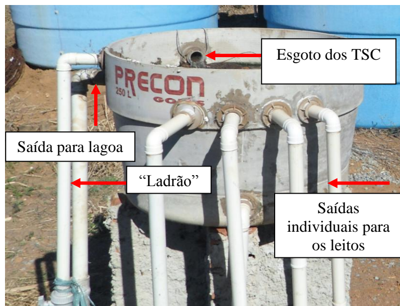
FIGURA 14. Caixa de distribuição de esgoto para os leitos cultivados.
