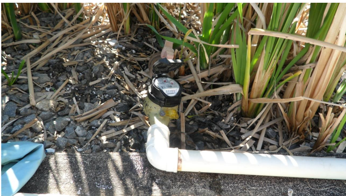
FIGURA 15. Hidrômetro instalado na entrada do leito cultivado para medição de vazão.
