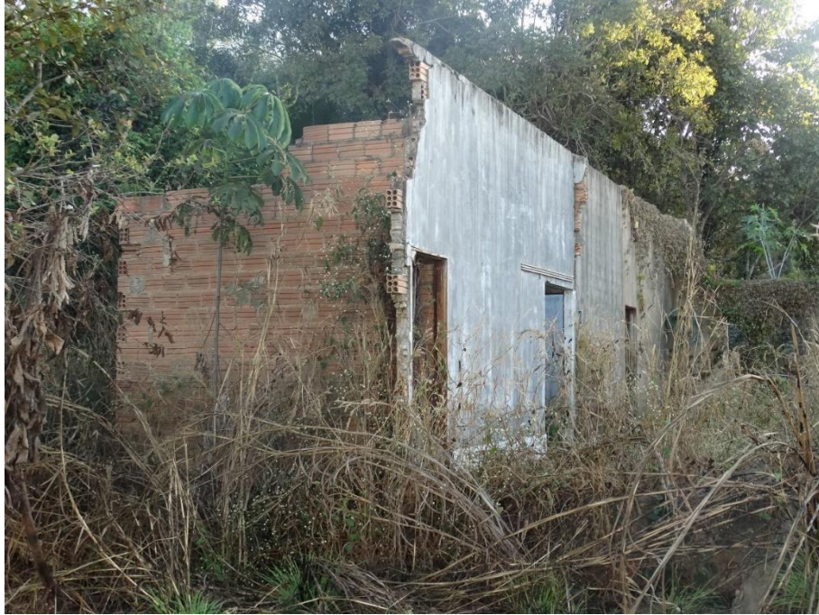
Figura 11 - Ruínas de uma casa no bairro Santos Reis, em Crixás
