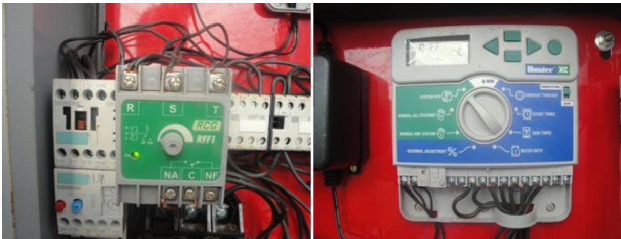
FIGURA 12. Relê falta de fase, relê térmico (A) e Controlador Hunter XC 8 estações.
