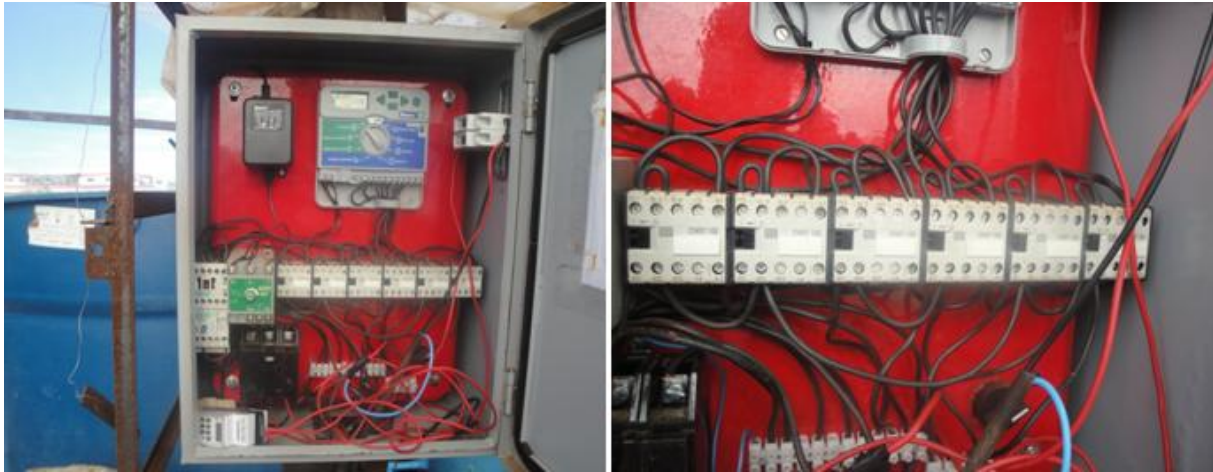
FIGURA 11. Quadro de comando completo (A) e conjunto minicontatora 24v (B).
