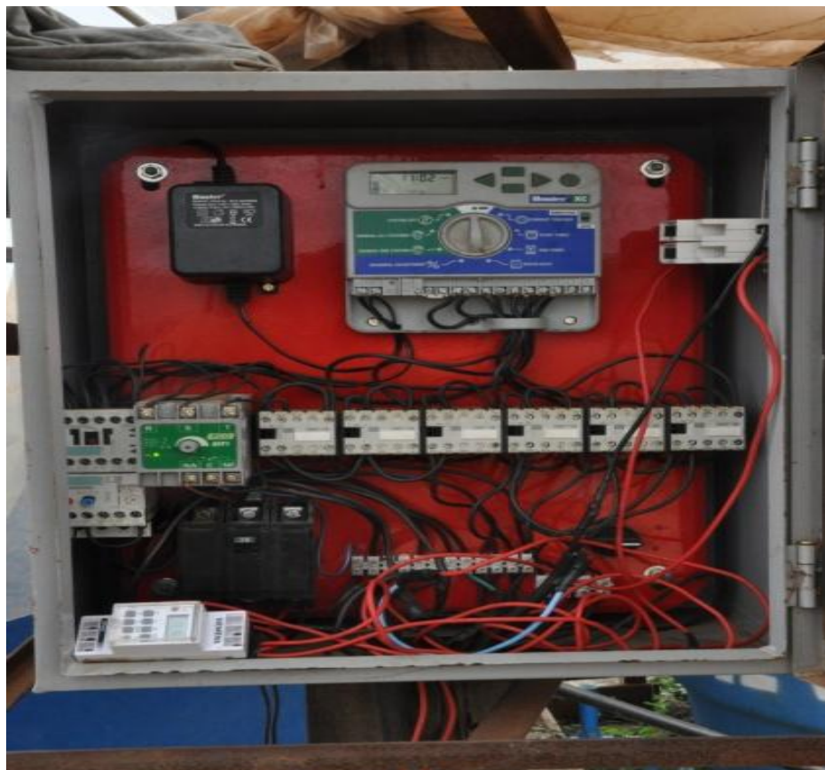
FIGURA 4. Visão geral da caixa de controle para automação do sistema de irrigação – UEG – UNUCET – Anápolis – 2012
