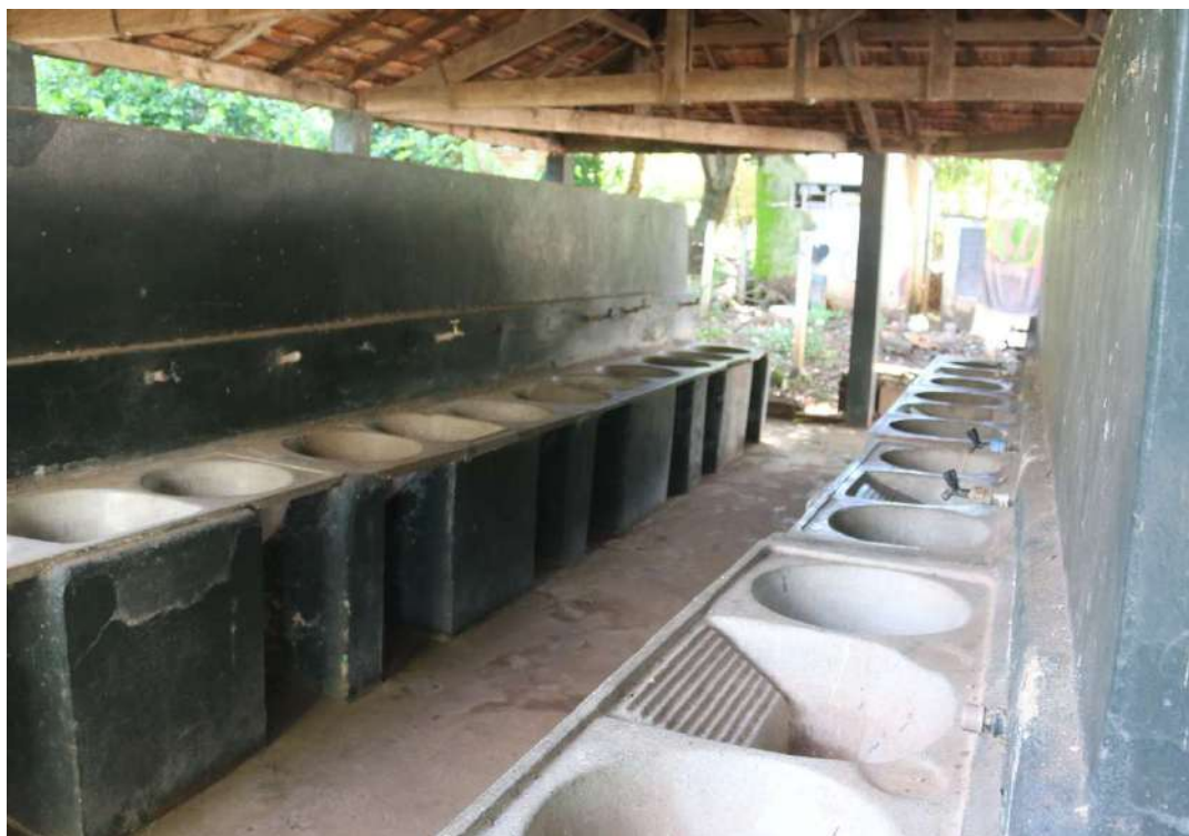
Figura 38: Disposição dos Tanques da Lavanderia Pública Santana (Foto: Fernando Arkanjo)
