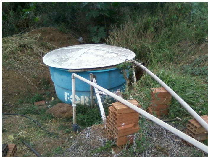
FIGURA 3. Reservatório de água residuária da ETE-UnUCET-Anápolis-GO.
