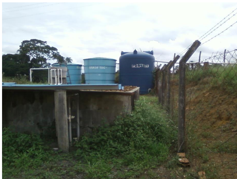
FIGURA 2. Vista dos tanques sépticos e leitos não cultivados da ETE-UnUCET-Anápoli-GO
