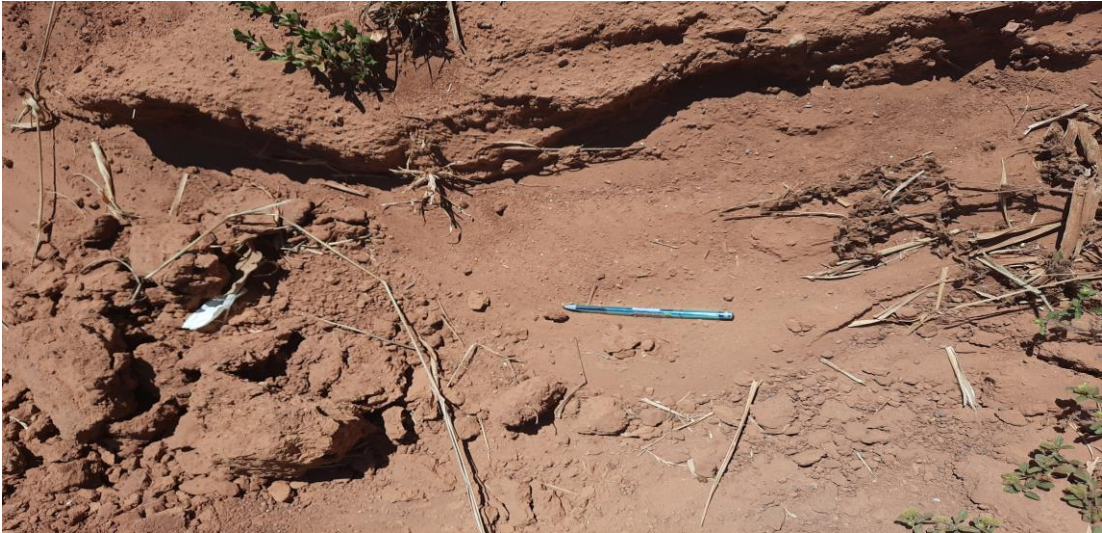
Figura 9 – Erosão em sulco abaixo do aterro
